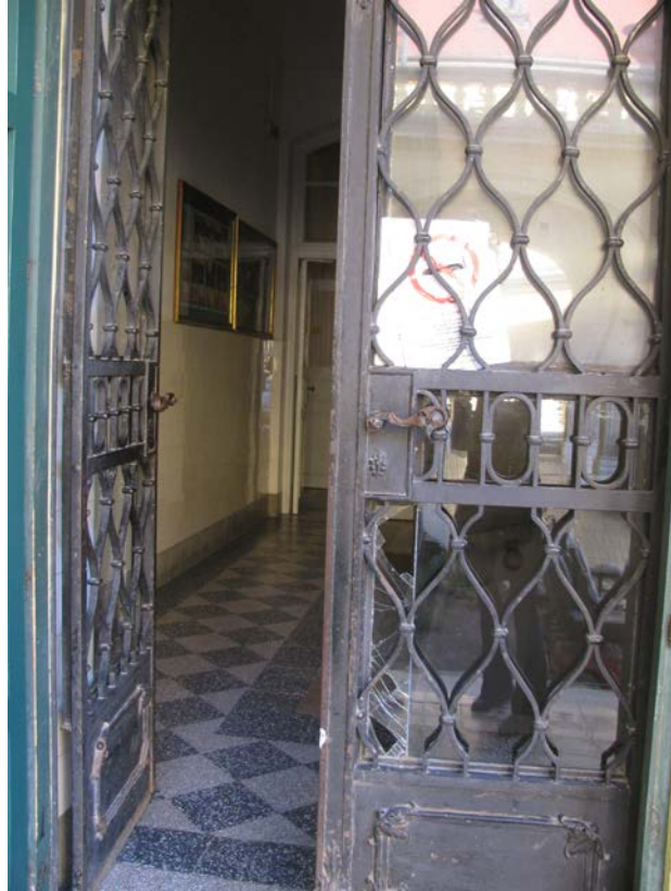
5. számú kép Törött üvegű bejárati ajtó
