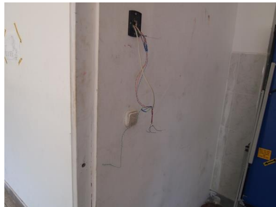
4. sz. kép: Balesetveszélyes vezeték az Otthon épületében
