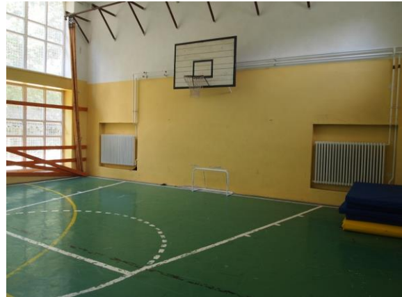
13. sz. kép: Tornaterem leszakadt védőrácossal
