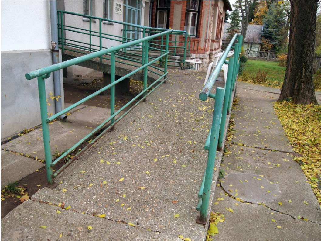
7. kép: feljáró és a betonút egyenetlenségei
